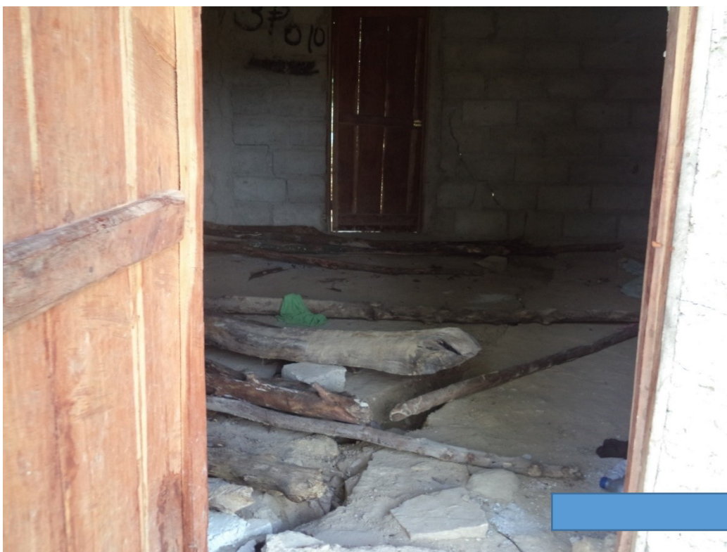
Figure 9: Maison détruites par le glissement. De grandes fissures observées à l'intérieur.
